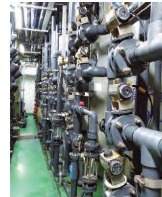
增設低耗水純水系統
