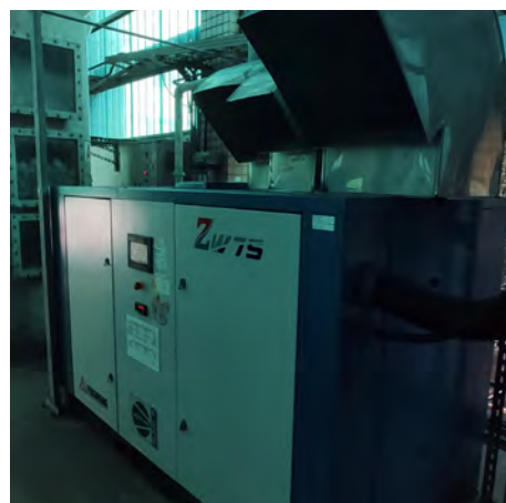
三號空壓機汰舊換新專案
