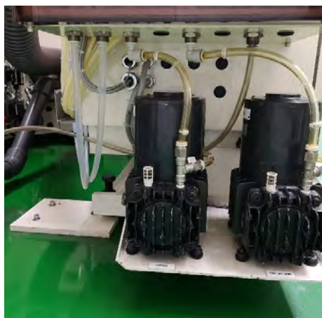
DGRD 設備減少真空 pump 使用數量
