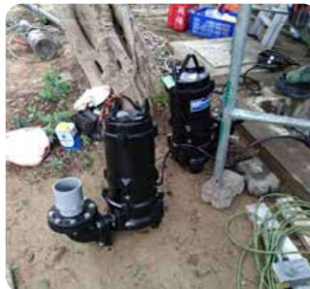
放流槽抽水 7.5HP 變頻案
