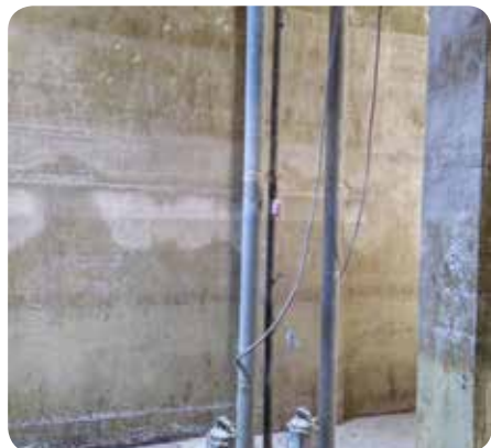
調勻槽抽水 3HP*2 台變頻案
